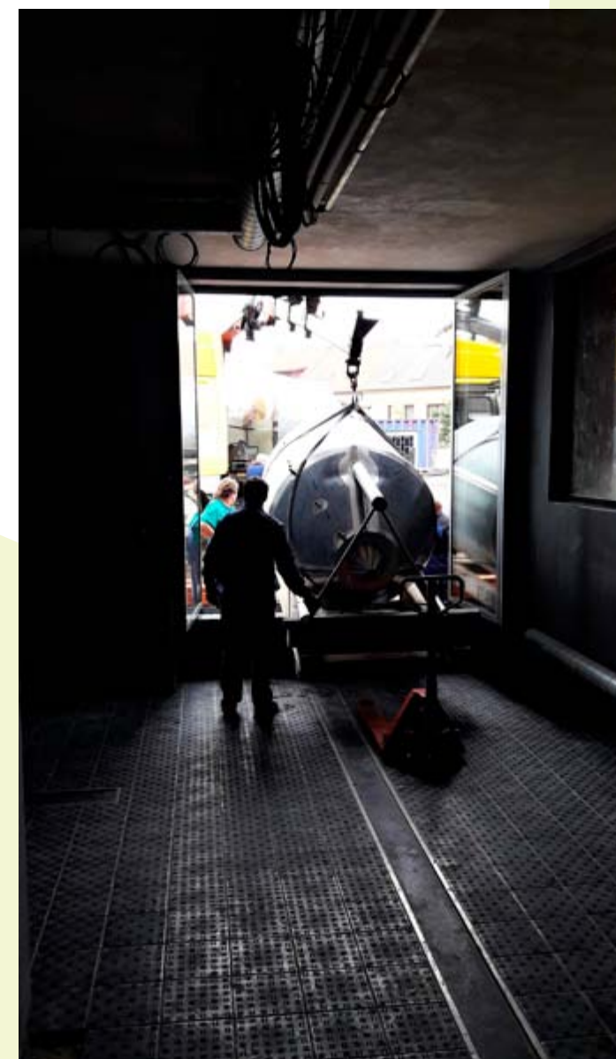
Na kvasné tanky bude vidět oknem ze zahrady i prosklenou stěnou přímo z restaurace, takže hosté budou mít pivo neustále pod kontrolou.
