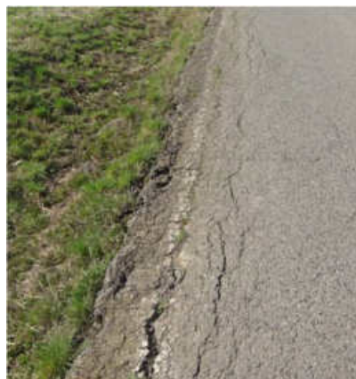
Degradovaný okraj vozovky v délce 40m
