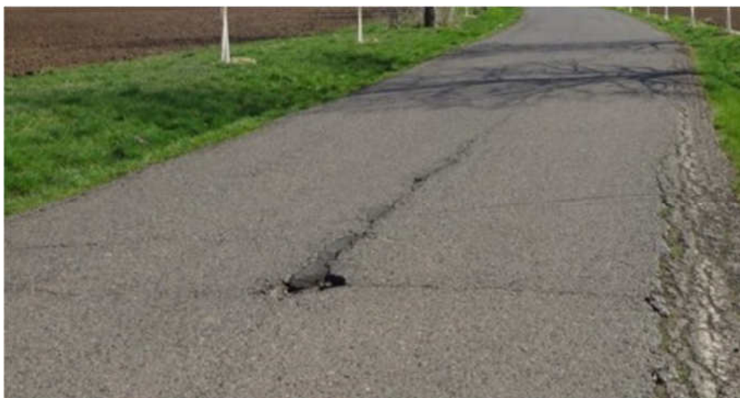
Obr. 33: Výtlupek ve středu vozovky, pokleslý a rozpraskaný okraj vozovky
