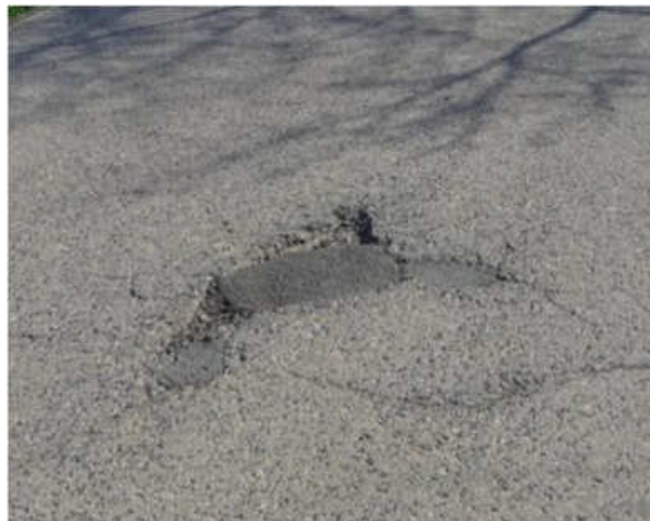
Nedostatečně opravený výtluk v krytu vozovky
