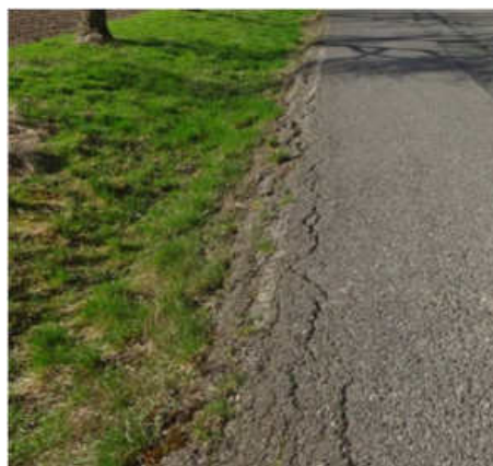
Zlomený okraj silnice, poruchy na kraji vozovky
