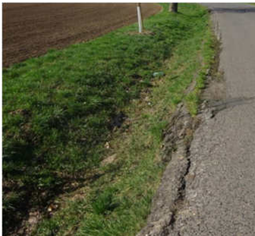
Obr. 29: Trhliny v okraji vozovky, nestandardní tvar příkopu;
