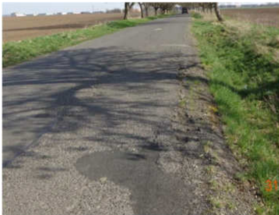
Obr. 44: Absence krytu vozovky na kraji vozovky, výtluk ve středu;
