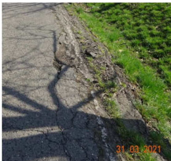
Obr. 36: Další lokalita s nebezpečnými prvky ve vozovce a přidruženém dopravním prostoru
