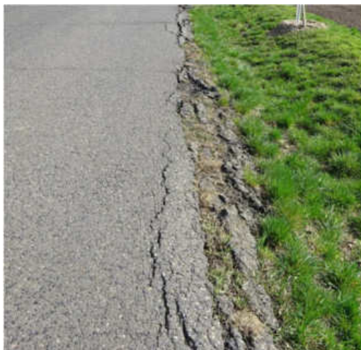
Obr. 35: Deformovaný okraj vozovky;
