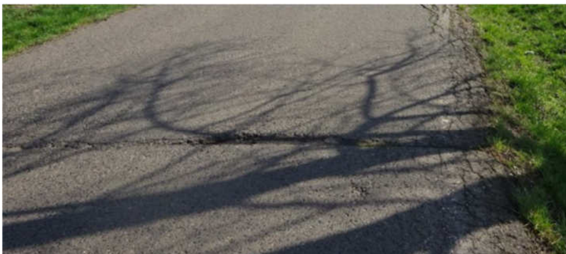
Obr. 30: Příčná porucha v jízdním pruhu, podélné trhliny zasahující 80 cm od kraje vozovky
