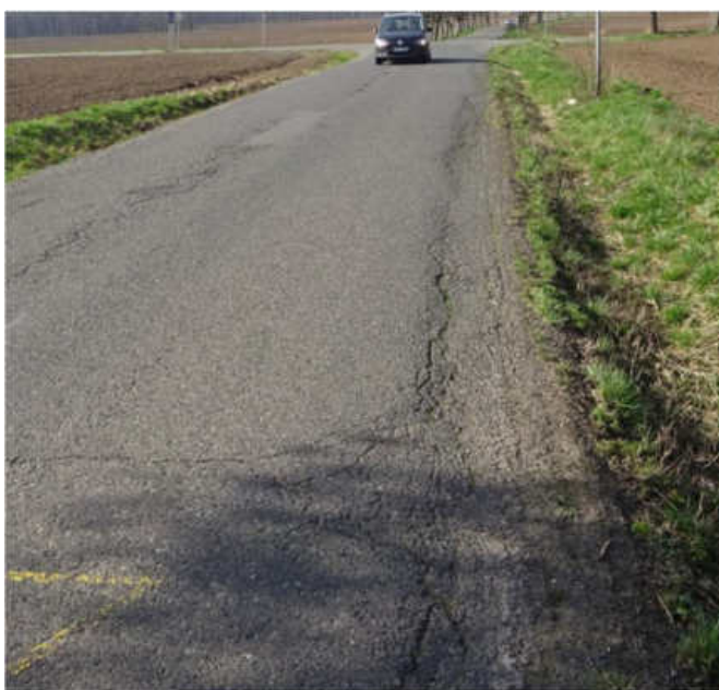
Obr. 19: Dokumentace nerovností krytu vozovky na jižním rameni křižovatky B
