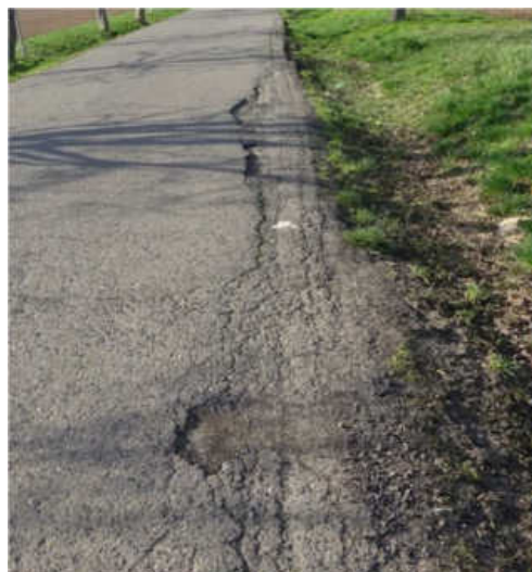
Podélný zlom krytu vozovky v trase pruhu pro cyklisty
