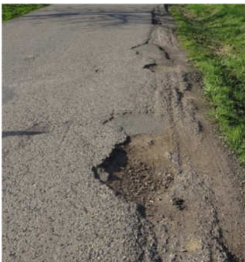
Obr. 37: Výtluk zasahující do podkladních vrstev vozovky;
