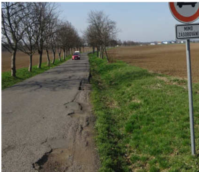
Obr. 18: Chybějící kryt vozovky
