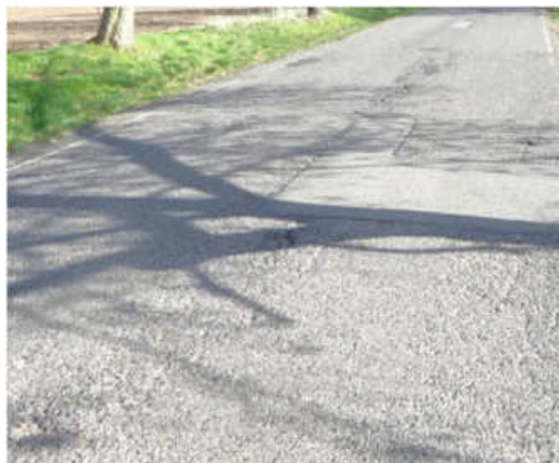
Výtluky ve středu vozovky
