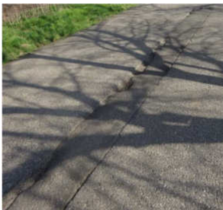
Obr. 45: Výtluky ve středu vozovky, nekvalitní oprava;
