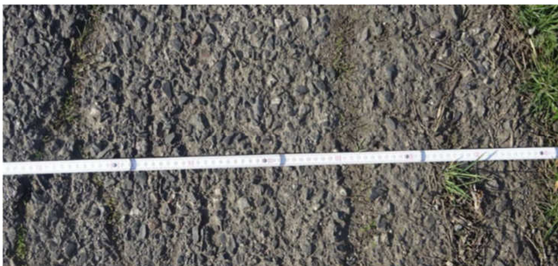
Obr. 21: Šířka zpevněné plochy je pouze 4,4 metrů
