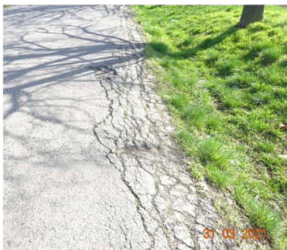
Obr. 31: Masivně degradovaný okraj vozovky;
