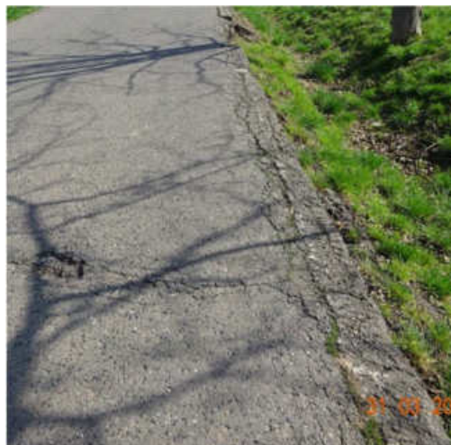
Výtluk, deformovaná hranice, příkrý okraj vozovky
